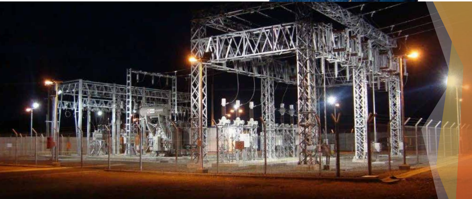
Subestación Los Tambores, La Unión
