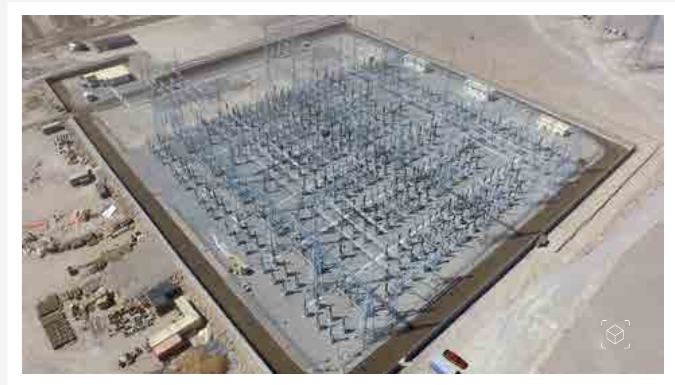
Subestación Kimal, Región de Antofagasta
